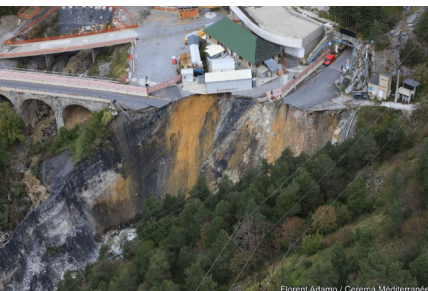
Infrastructure effondrée dans la vallée de la Roya en octobre 2020 (source : CEREMA Méditerranée)
