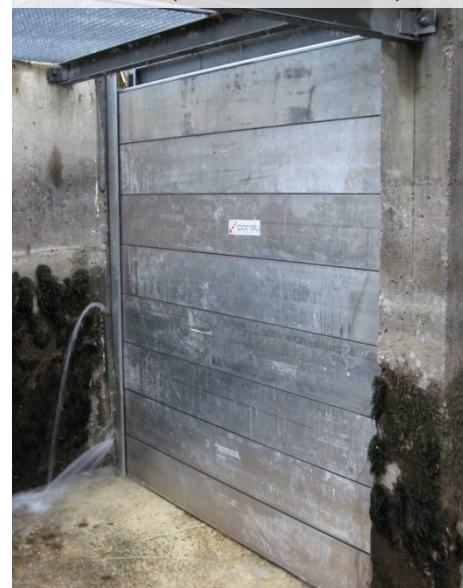
Batardeau (inter. hors d'eau)
