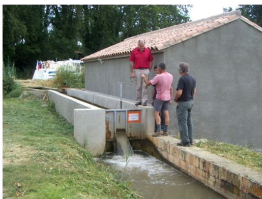
Prise de Puicheric dans le canal du midi, station de pompage et alimentation gravitaire de la nappe
