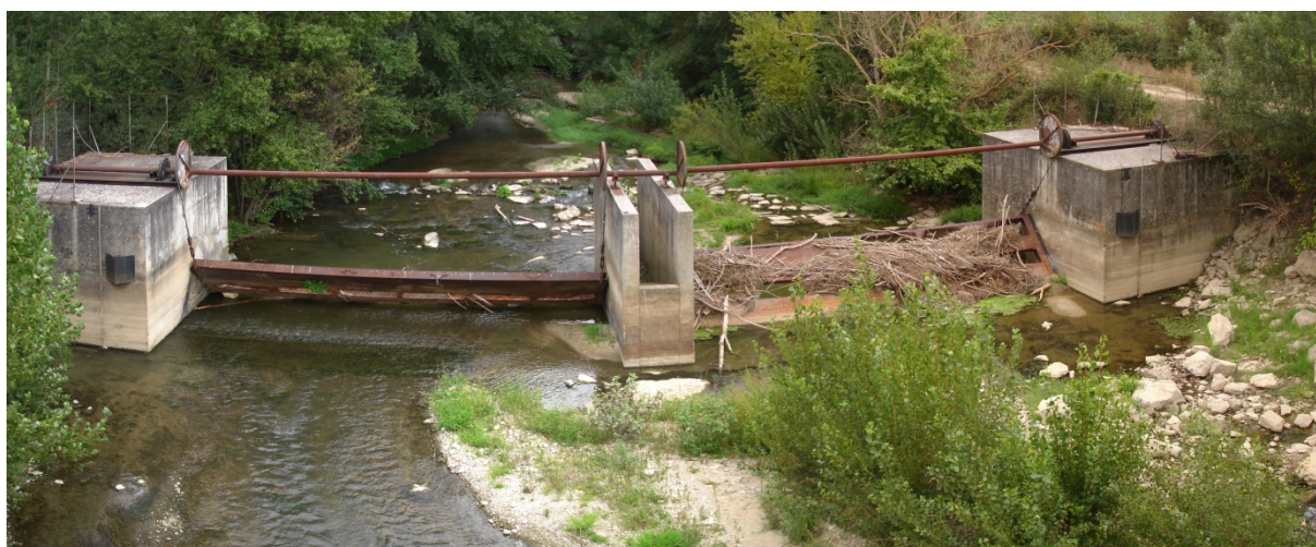
Figure 18 : Barrage crevé de Pont de La Chaux (Août 2011)
