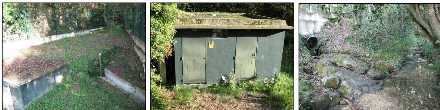
Figure 3 : Captage de la source de La Foux, poste de chloration et surverse
