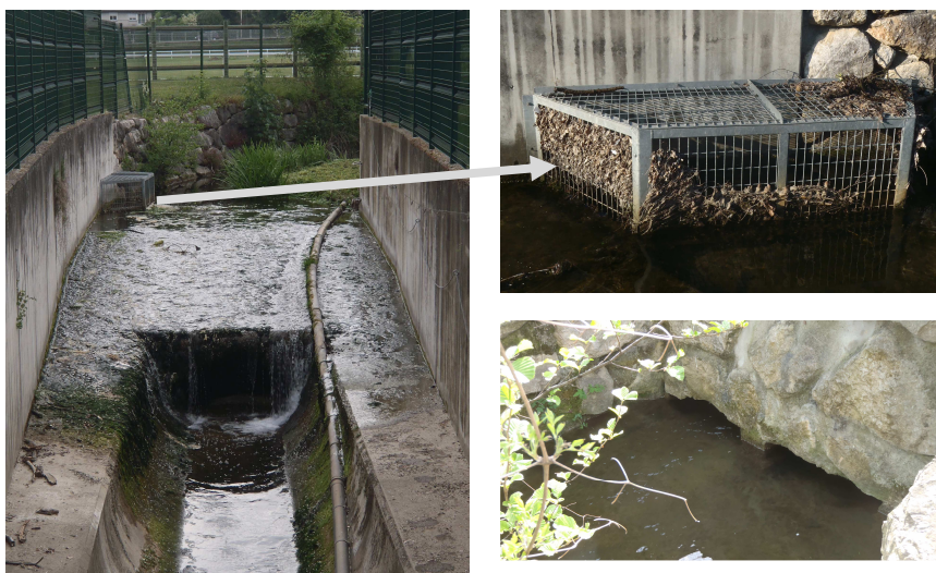
à gauche la canalisation vers la galerie, à droite et de haut en bas, la grille protégeant la buse et la buse derrière le mur en béton laissant s'écouler le Tillet « naturel ». Photos : D. COLLET.
