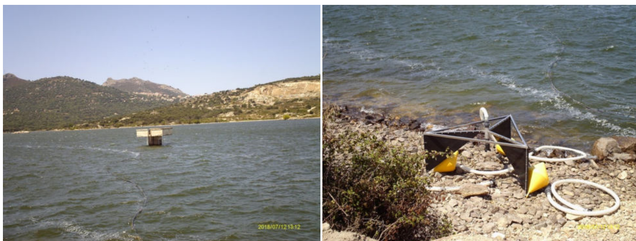
photo 1 : installation de l'aérateur hypolimnique le 12 juillet 2019
