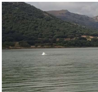
Photo 1 : vue sur un aérateur hypolimnique installé sur Codole (cliché S.T.E. campagne 3, 2021)
